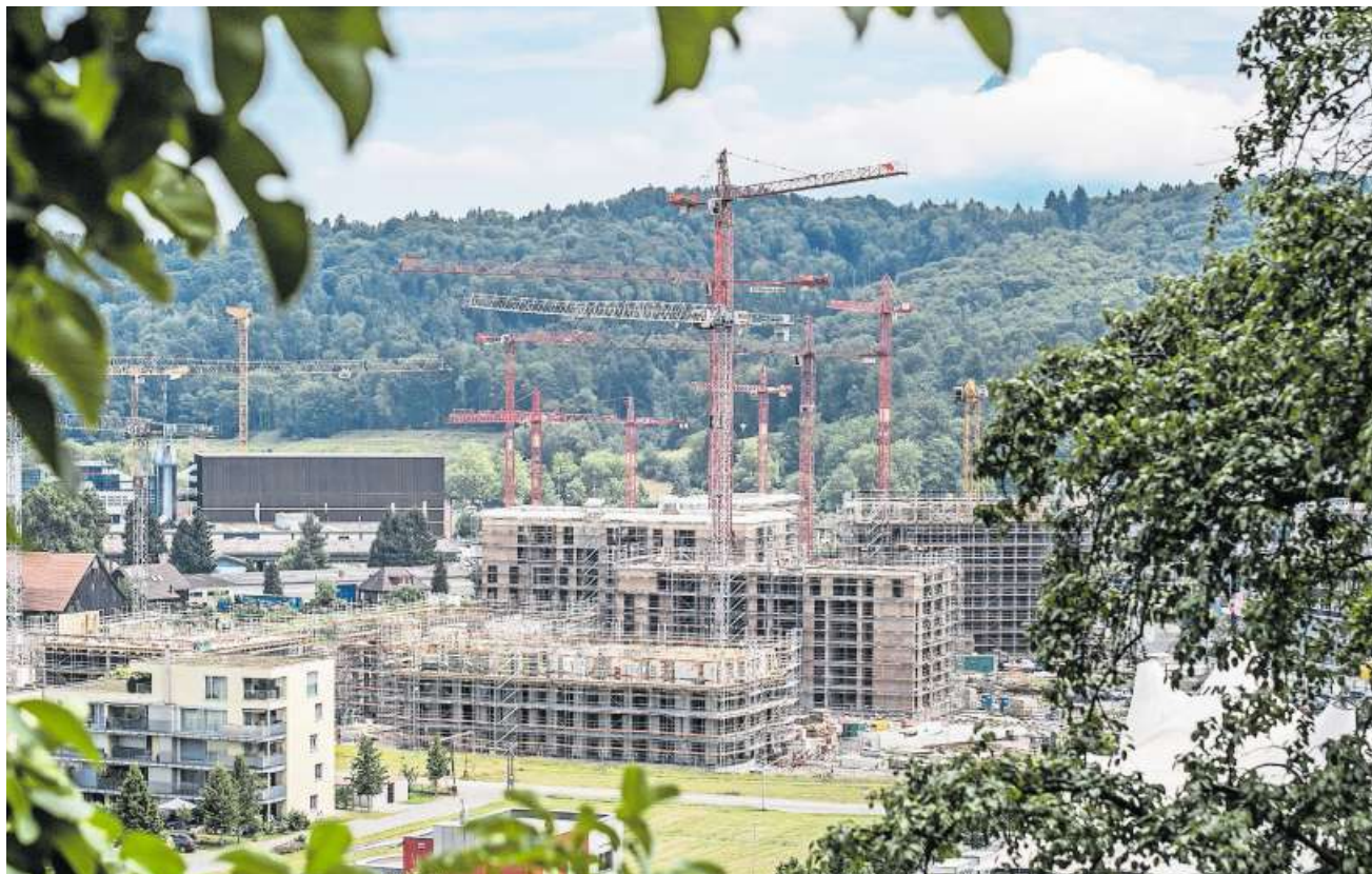
Zentrumsnaher Wohnraum ist gefragt: In Kriens, auf dem Gebiet Luzern Süd, entsteht zurzeit die Grossüberbauung «Schweighof». Bild: Pius Amrein (27. Juni 2017)
